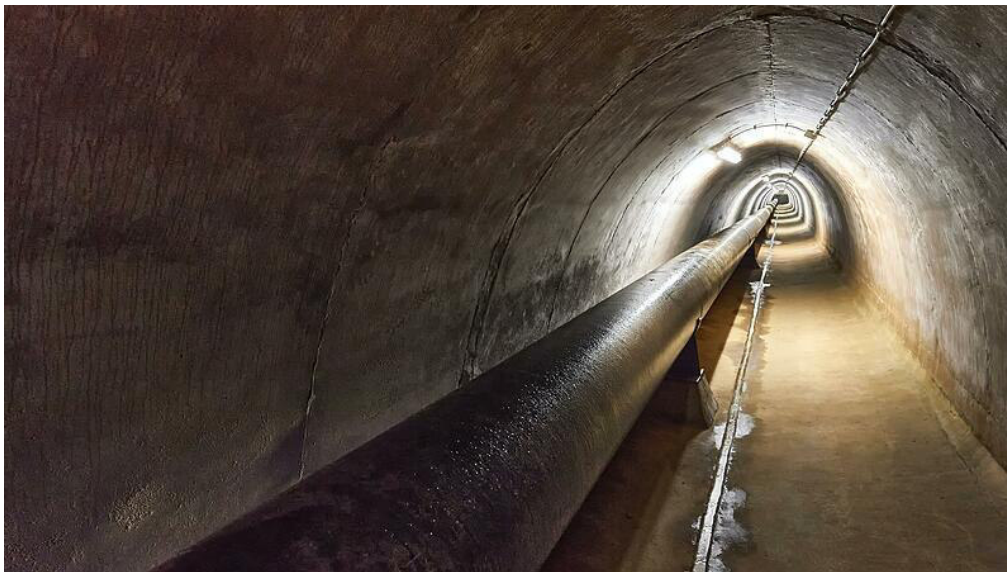
Foto: Anand Anders | Die Rohrleitung im Tunnel zum Grundablass im See ist von Bakterien zerfressen und muss ausgetauscht werden.
