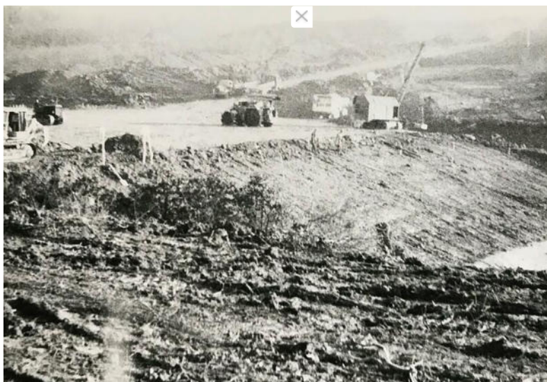
Foto: Wasserwirtschaftsamt Bad Kissingen | Mit schwerem Gerät war die Nürnberger Baufirma im Wiesengrund zugange.
