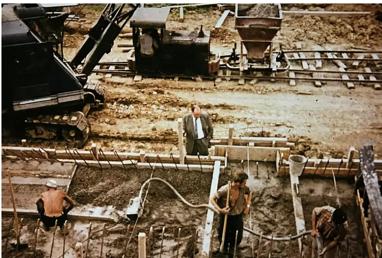
Foto: Wasserwirtschaftsamt Bad Kissingen | Eine Baufirma aus Nürnberg errichtete den Damm am Ellertshäuser See.
